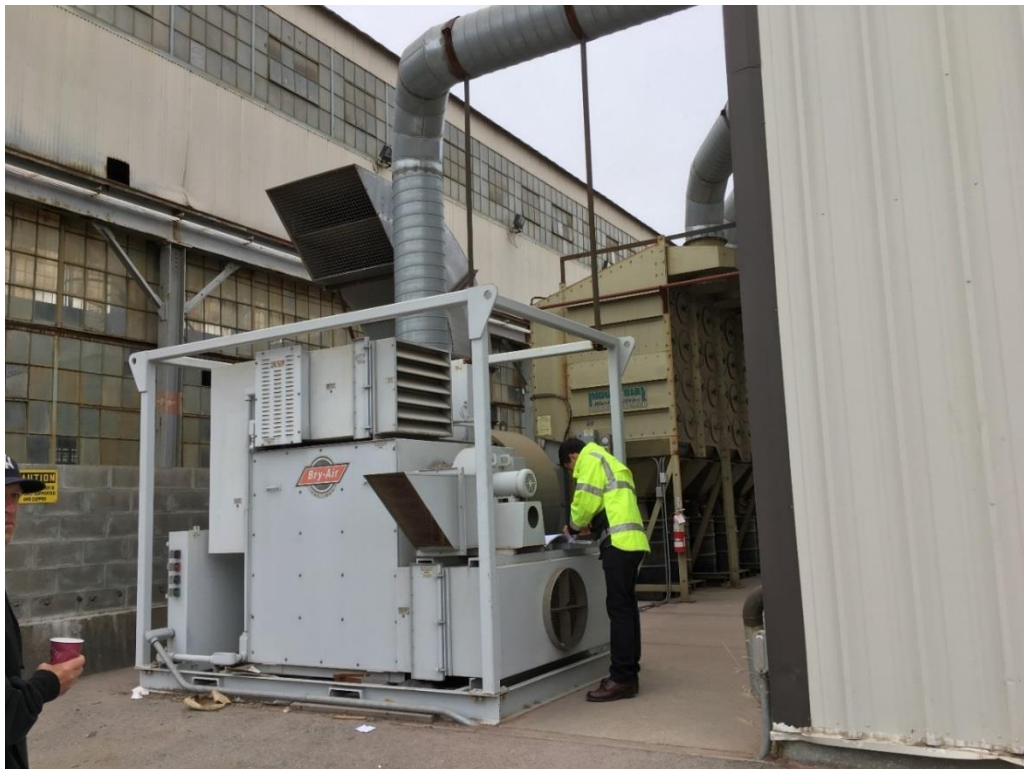
Sand Blast Booth (Bldg. 251) Dehumidifier
